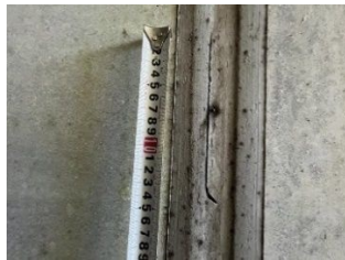
写真-1 シーリング材の劣化
